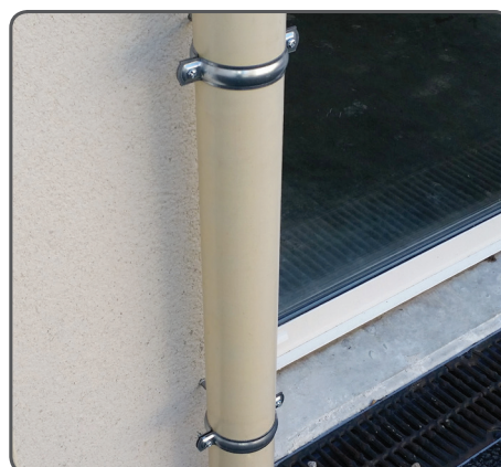
Collier descente eaux pluviales
